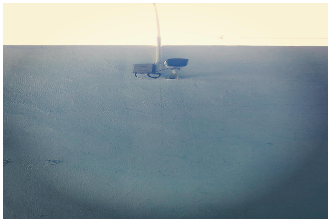
磷化车间废水排放口及监控系统
